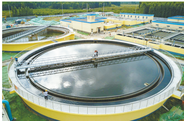
在济南经开区污水处理厂,工作人员正在对污水处理各项指标进行监测,全力做好城市污水收集处理,确保出水达标。
